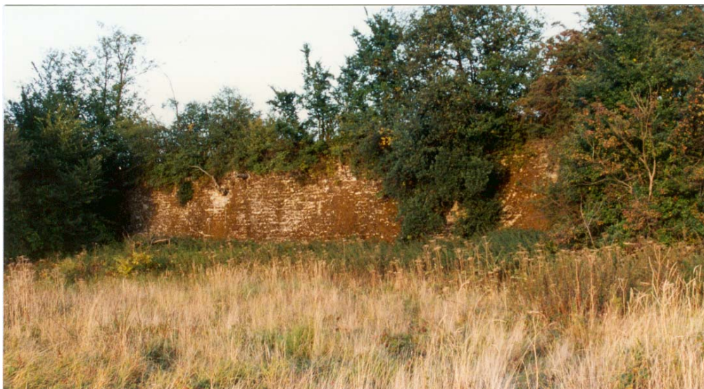
État actuel du mur de retenue de l'étang du trou Salé à l'ouest de la RD 938.(photo P.Bessas)
