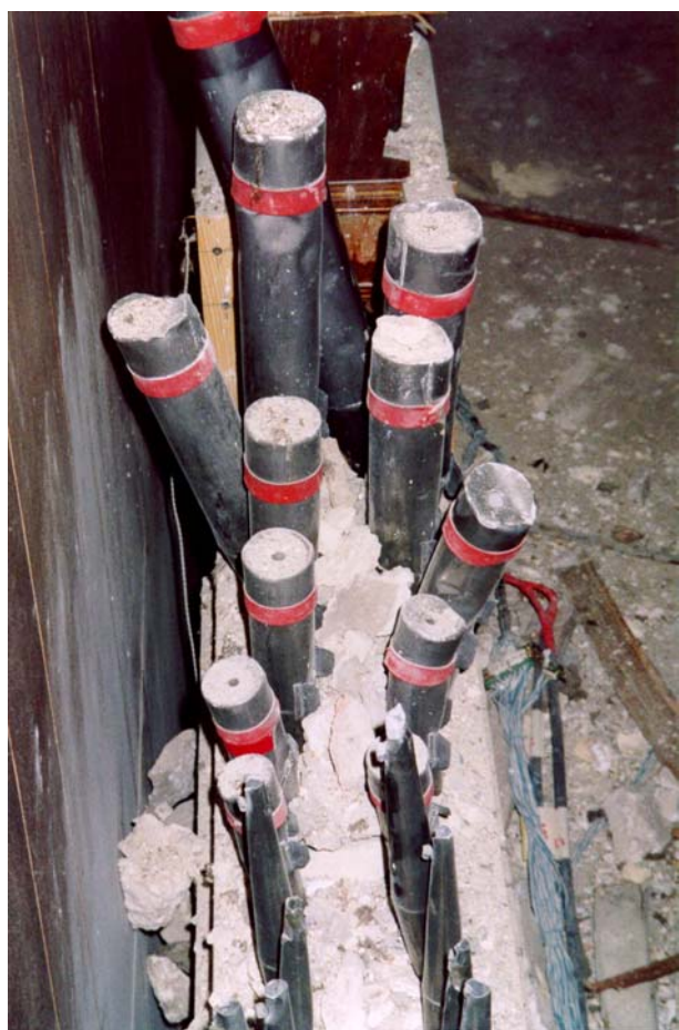
Un jeu de tuyaux après l'accident en août 1997
